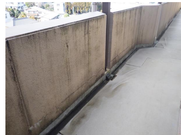
塗装面の劣化
